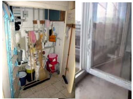
„Hausmeisterraum“ und marode Fenster
